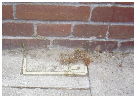
Veel ontluuchtingopeningen naar de kruipruimtes zijn volgestord met beton:
